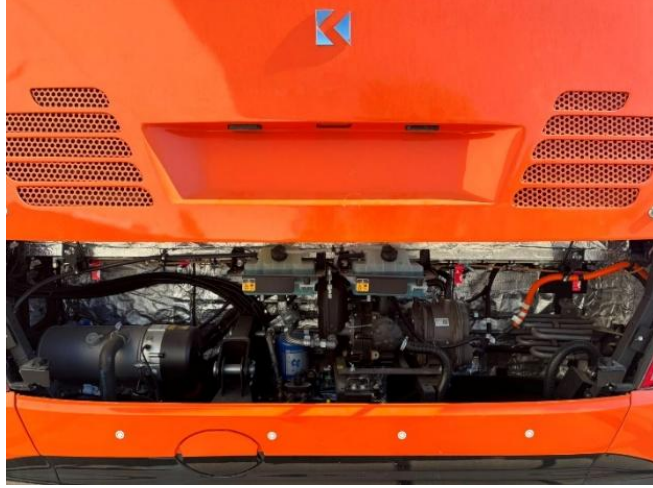
Şekil 6 Araç Üzerinde Hava Kompresörünün Yerleşimi
